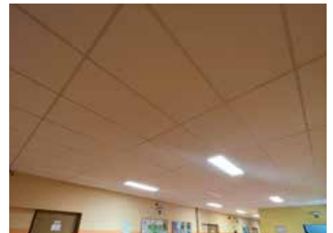
Sufity akustyczne w obu szkołach podstawowych to innowacyjna inwestycja, dzięki której znacząco zwiększył się komfort nauki, jak i pracy, a także ich efektywność
