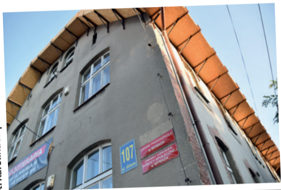
Dach budynku przy ul. Głównej 107 już od dłuższego czasu stanowił zagrożenie dla bezpieczeństwa z powodu odpadających dachówek
