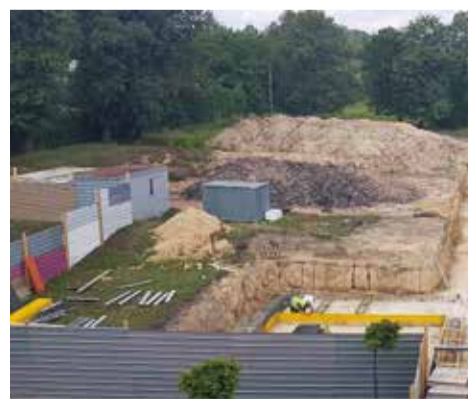
Teren budowy został bardzo dobrze ogrodzony, obecnie wykonawca prowadzi prace związane z budową fundamentów
