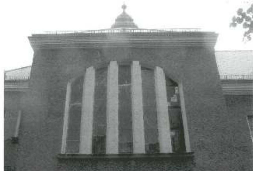
Kościół pw. św. Anny w Wyrę, po gradobiciu.
